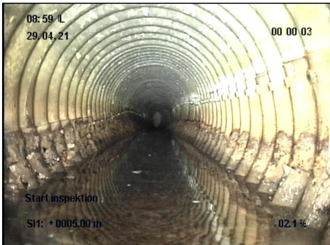
Figur 4. Bild från trumma som redovisar den odeformerade formen samt rotskadorna kring botten av ledningen.
